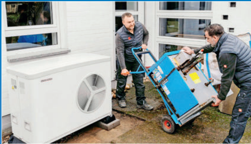
Alte Heizung raus, Wärmepumpe rein: Der Umstieg auf die umweltfreundliche Heiztechnik ist auch in älteren Gebäuden ein sinnvoller und wirtschaftlicher Schritt. Foto: DJD/Stiebel Eltron
