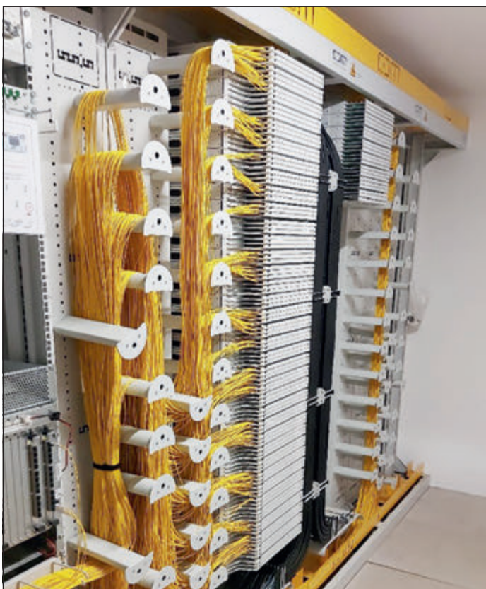
Die Technikstation ist das Herzstück eines Ortsnetzes. Hier laufen alle Glasfaseranschlüsse der Kunden zusammen. Foto: Netzgesellschaft
