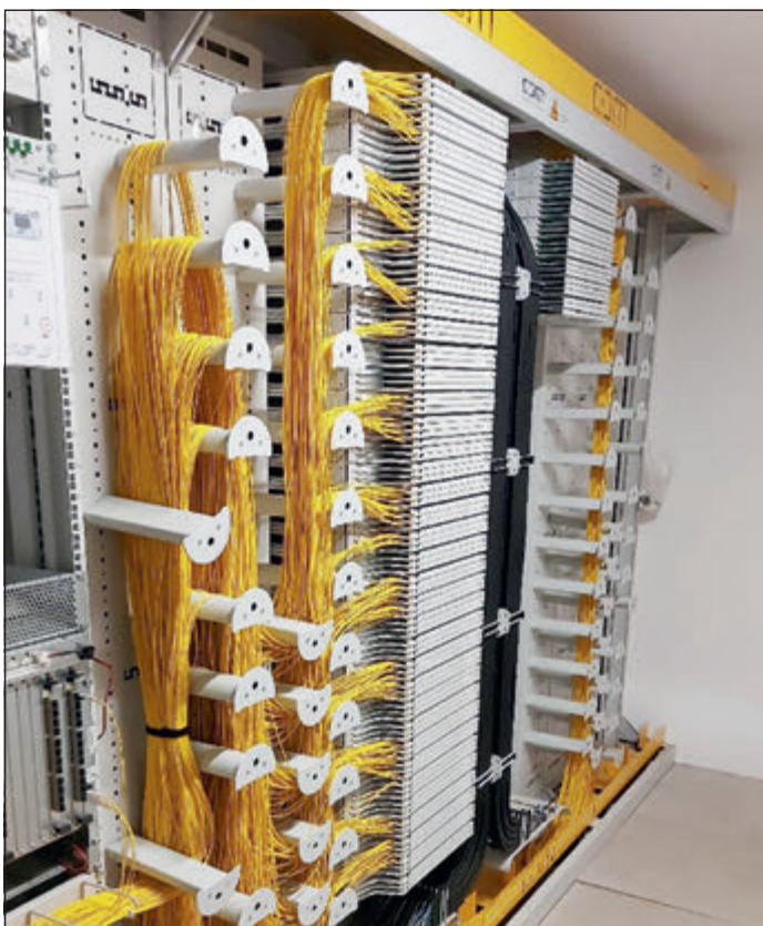
Die Technikstation ist das Herzstück eines Ortsnetzes. Hier laufen alle Glasfaseranschlüsse der Kunden zusammen.
